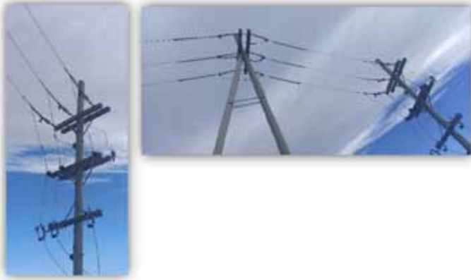
Fotos 3 y 4. vista de cobertores colocados en cables de líneas eléctricas.
